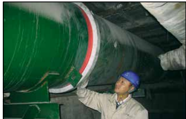
40" Rings an einer Förderleitung in China (Stahlindustrie)
